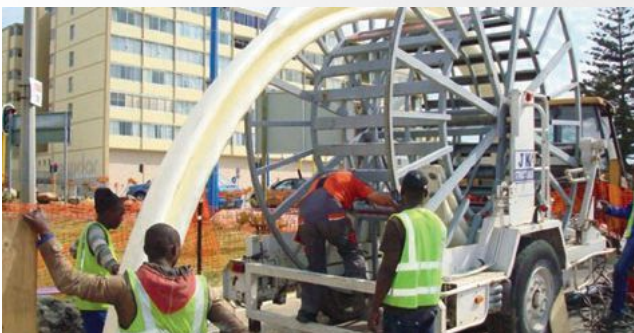
Südafrika, Durban, DN250, Abwasser
