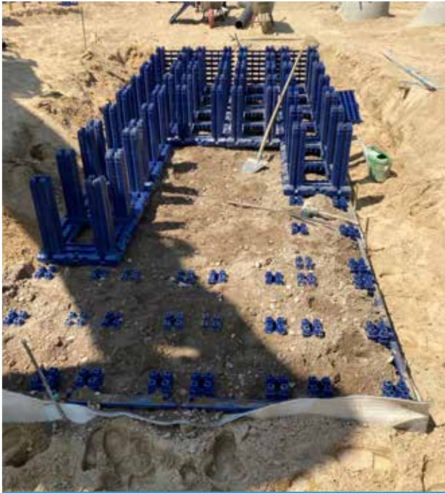
Insgesamt sechs Wurzelkammersysteme werden im bayerischen Schwandorf eingesetzt, um Stadtbäumen optimale Wachstumsbedingungen zu bieten. Der Aufbau erfolgt hier zweilagig.
